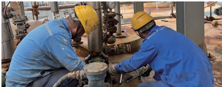
连日来,面对持续高温天气带来的严峻挑战,凯实金桥公司一线员工充分发扬拼搏奉献精神、不惧酷暑,铆足干劲,用汗水和担当迎“烤”验、战高温、斗酷暑、保安全、争效益。图为氯化苯装置盐酸精制平台P0511泵机封漏水,设备管理部设备组韩善才和成广智更换泵机密封。(张昕、糜雨晴、江超)
